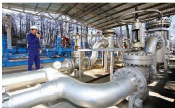
منطقه شمال - ایستگاه فشار شکن لاجیم
