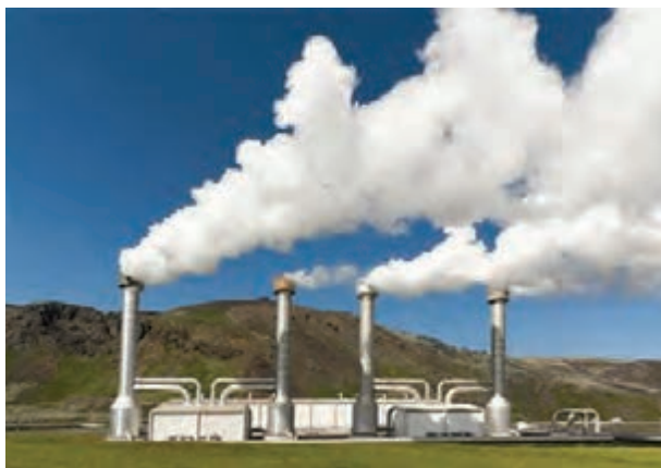
شکل ۱۱-۴- نیروگاه زمین گرمایی مشکین شهر - اردبیل
